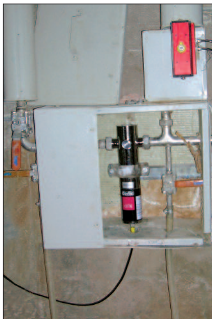
Slambaltsgivare CTX 20/25K är installerad på pumpledningen mellan vitlutsfilter och vitlutstank.
