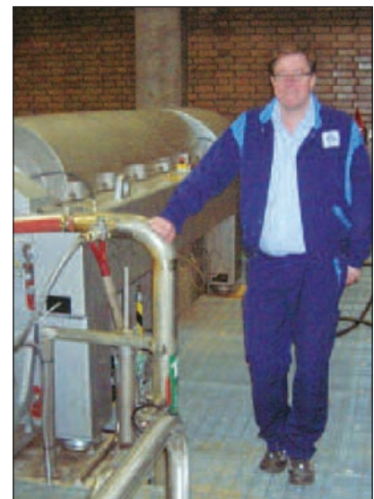
Bengt Westin vid den centrifug där Cerlics dränkgivare är installerad för övervakning av utgående rejektvatten.
