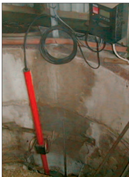
Cerlics susphaltsmätare sitter på leveranspunkten till reningsverket och bestämmer vad som skall återföras, antingen direkt eller via buffringssystemet. På så vis styrs kemikaliedoseringen.
