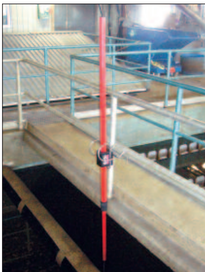
På Trotab regleras tillflödet med hjälp av Cerlics susp/slammhaltsmätare ITX.
