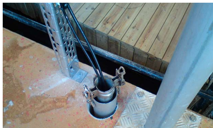
Röret som trycker in ITX-givaren i sugledningen hålls fast med en enkel fästeanordning i det 1,8 meter långa ytterröret, som är svetsat mot sugledningen.
