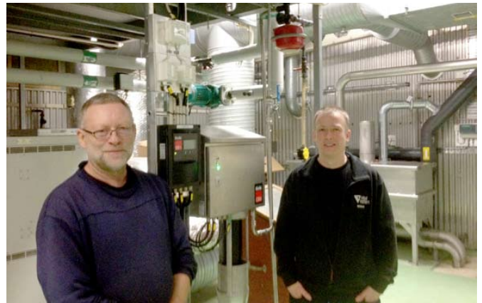
Owe Söderberg och Magnus Andersson, drifttekniker på reningsverket i Munkedal, har fått färre ”akut-utryckningar” tack vare den nya CBXen i slamförtjockaren.
